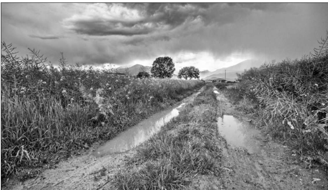
Die Güterstrassen haben zum Teil stark unter der Nässe gelitten.
